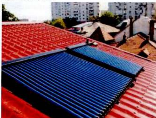
Figura 16 - Panouri solare – pentru apa caldă
